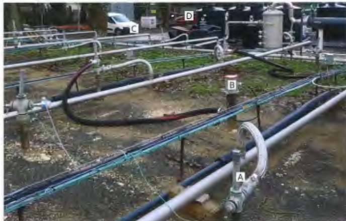
6 Ouvrages d'extraction vus sur site: A Puits d'extraction B Pointe chauffante C Réseau d'extraction D Unités de traitement
